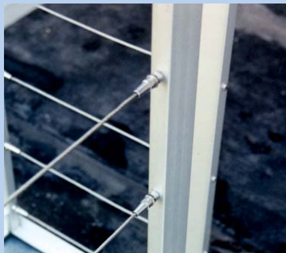
Garde-corps sur base de câbles en inox
